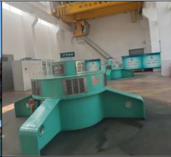
发电机组现状
