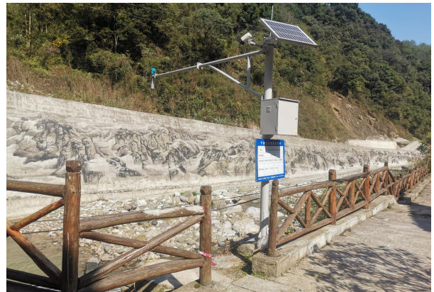
下泄流量监控设施
