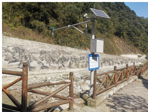
下泄生态流量监控设施
