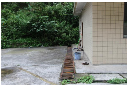
生活区排水沟
