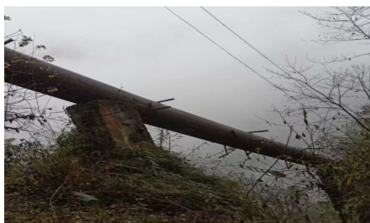
图 2.6-2 项目压力管道
