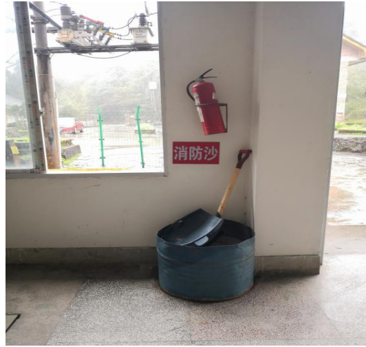
厂区应急设施
