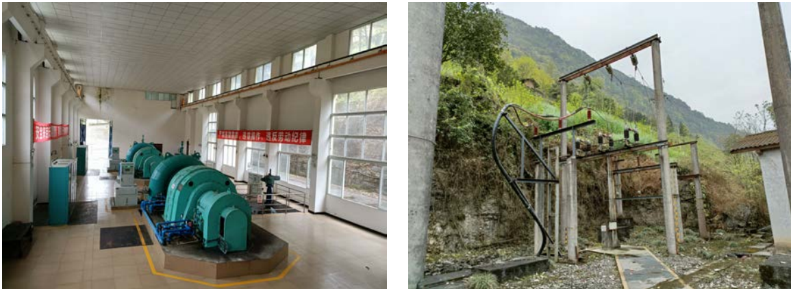
图 2.5-3 五渡水电站发电机组及升压站
